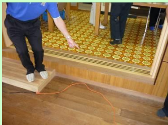
現地調査にて段差を確認
